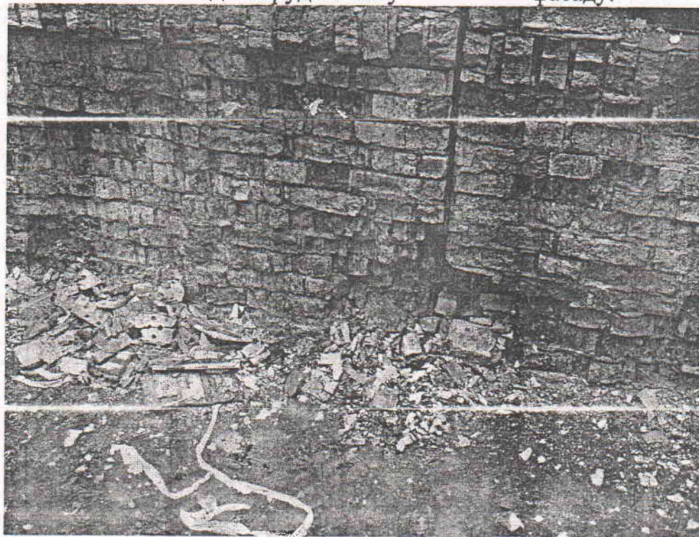
Фото № 2. Зволоження та руйнування цегляного мурування стіни головного фасаду.
